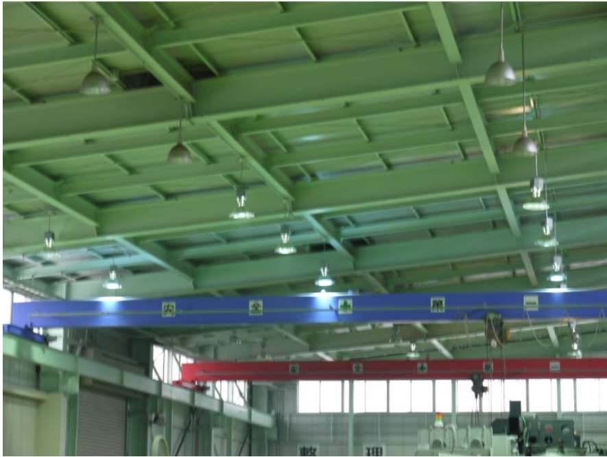
エネブライト導入状況（H社 組立工場）
